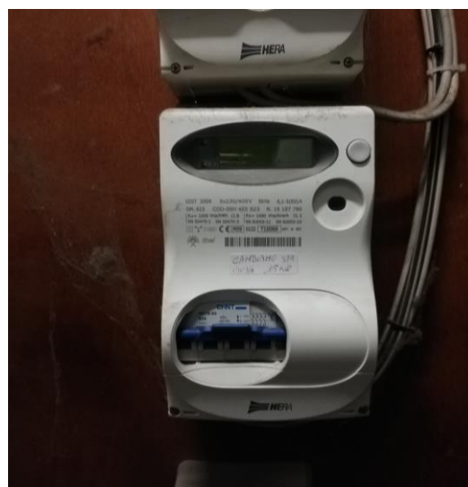
DETTAGLIO INTERRUTTORE GENERALE
